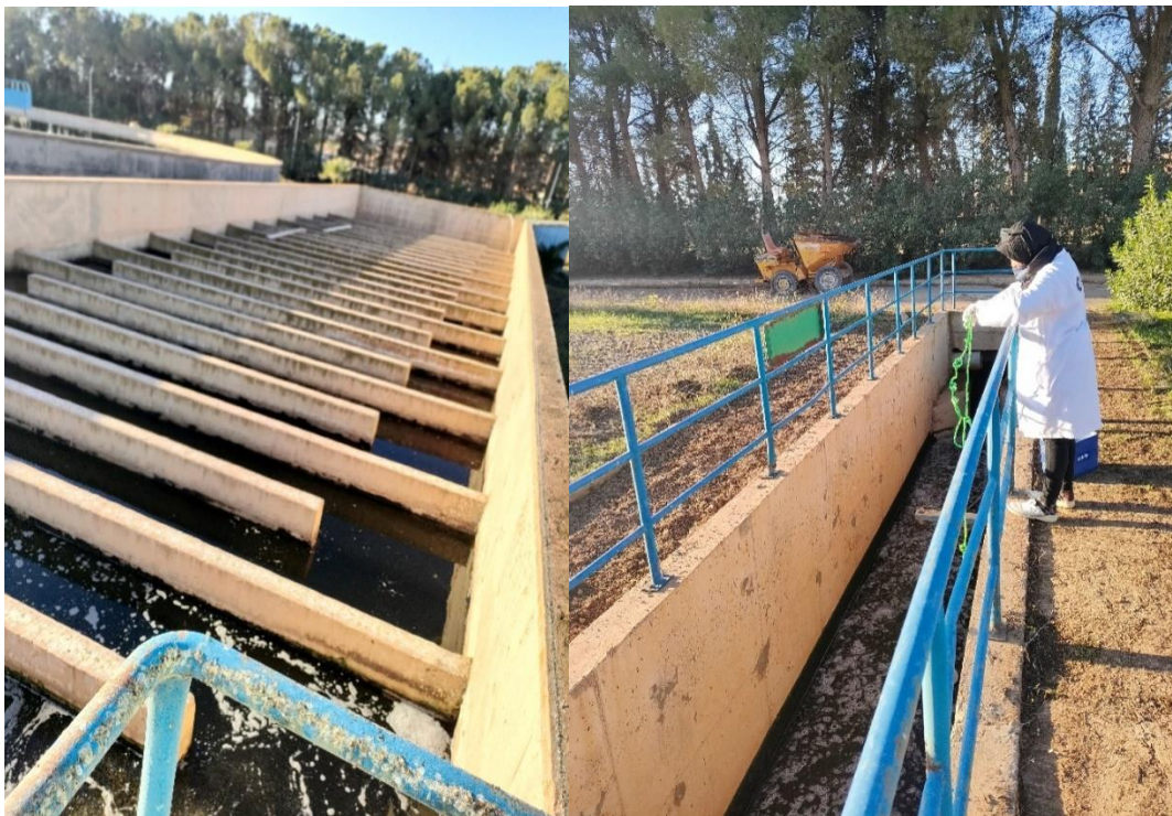
Fig. 11 : Bassin de chloration (Station de Saida : Janvier 2022)
