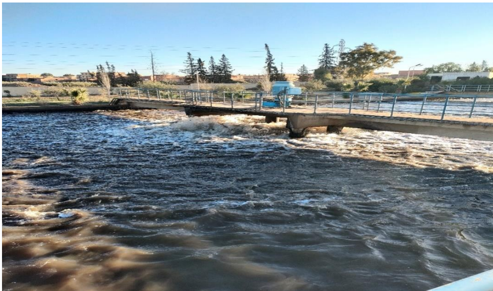
Fig. 07 : Bassin d'aération. (Station de Saida : Janvier 2022)
